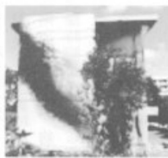
墜落現場校舎写真
